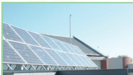
Capteurs anémométrique et d'énergie radiative sur les panneaux solaires. Les données relevées en continu à longueur d'année peuvent être intégrées dans une base de données du réseau du lycée.
